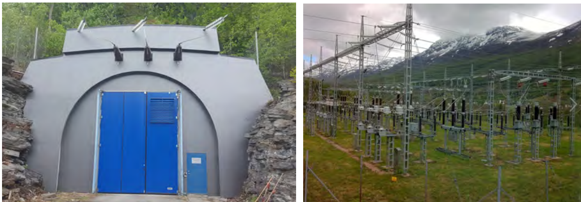
Figur 7-2 Guoláš kraftverk med trafo.
