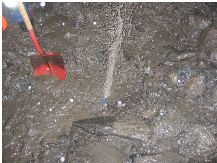
Bilde 1 Lekkasje Løkvoll 2005, Foto: Stine Pedersen
